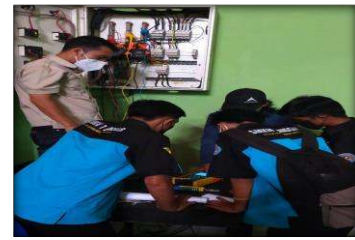
c. Pengukuran kualitas daya beban panel MDP 3 fasa
