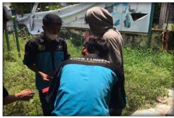
a. Pengukuran tahanan pentanahan sistem PLTS
