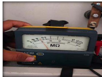
b. Tahanan isolasi pada instalasi sistem PLTS
